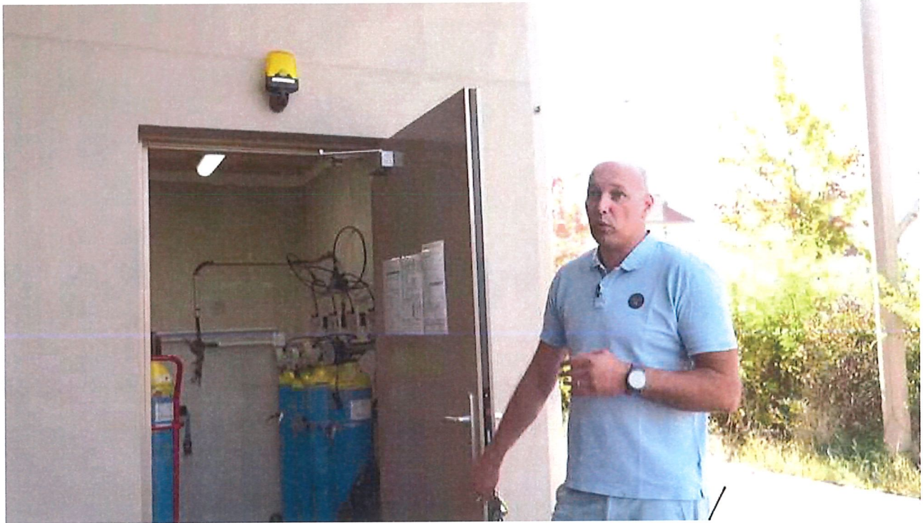
La fuite a été détectée dans ce local. ● © Rodolphe Augier - France Télévisions
