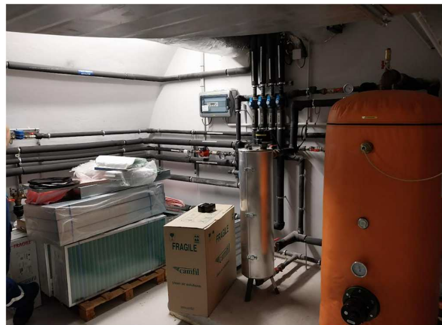
ZONE POSITIONNEMENT SKID RCU DANS LE LOCAL CTAs
