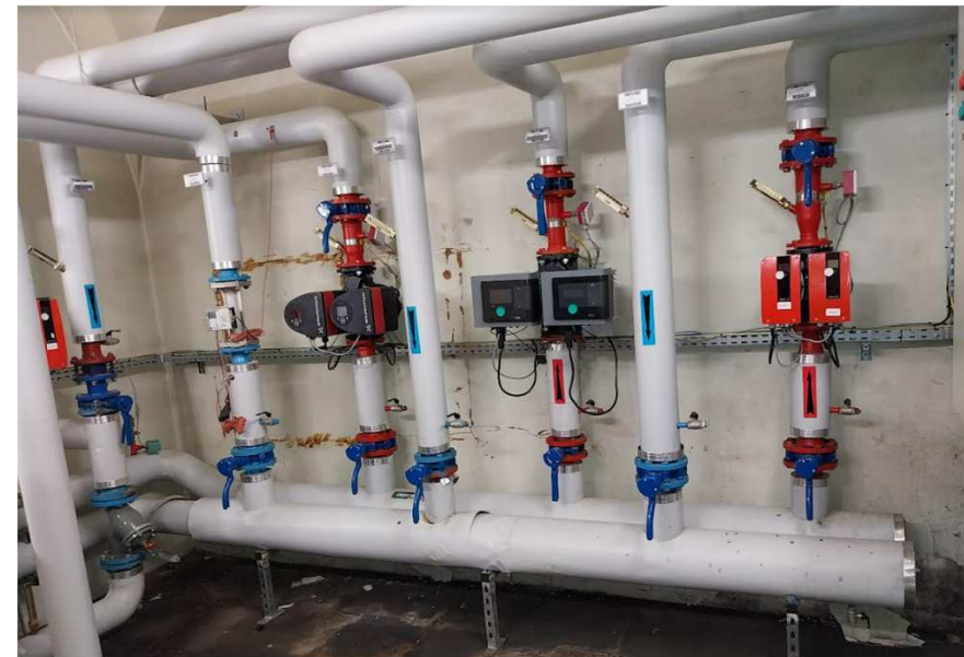
SOUS STATION ARRIVEE RESEAU SECONDAIRE
