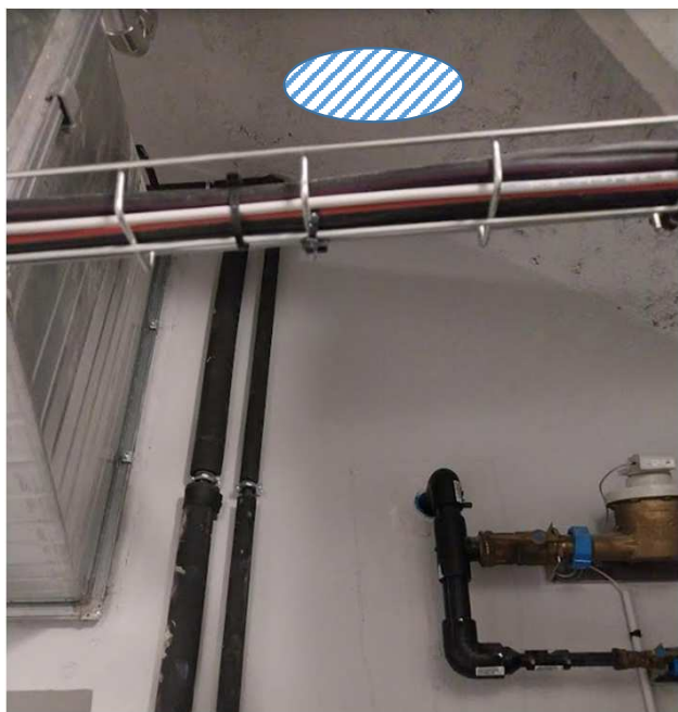
ZONE D'ARRIVEE DU RCU DANS LE LOCAL CTAs
